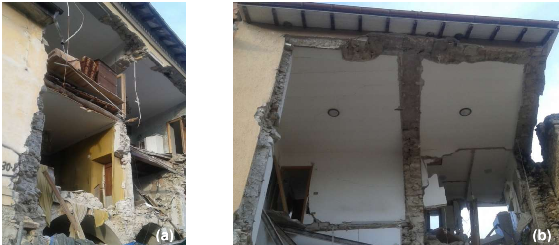
Figura 36 (a) e (b): esempi di edifici che non presentano variazioni di quota ma sono interessati da gravi danni strutturali dal momento che le pareti perimetrali non esistono più nella figura a e nella b sono crollati anche i solai. Amatrice, rilievo effettuato in seguito al terremoto del 24 Agosto 2016.
